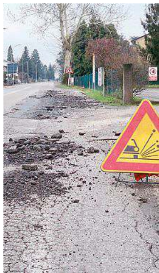
Una strada dissestata
